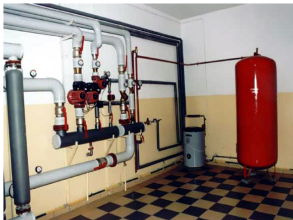
Zdj. 5. Zbiornik akumulacyjny i naczynie przeponowe
